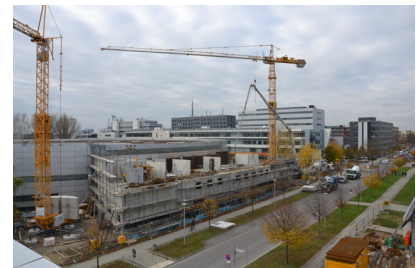
High-Tech-Bau neben High-Tech-Bau: Das „Energy Materials In-Situ Laboratory Berlin“ (EMIL) entsteht als Anbau neben der Synchrotronlichtquelle BESSY II des HZB. Foto: HZB
